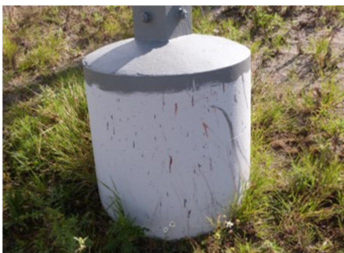
Figuur 1.15 Een voorbeeld van de verharding boven maaiveld van een mastvoet, bij een met beton gevulde stalen buispaal
