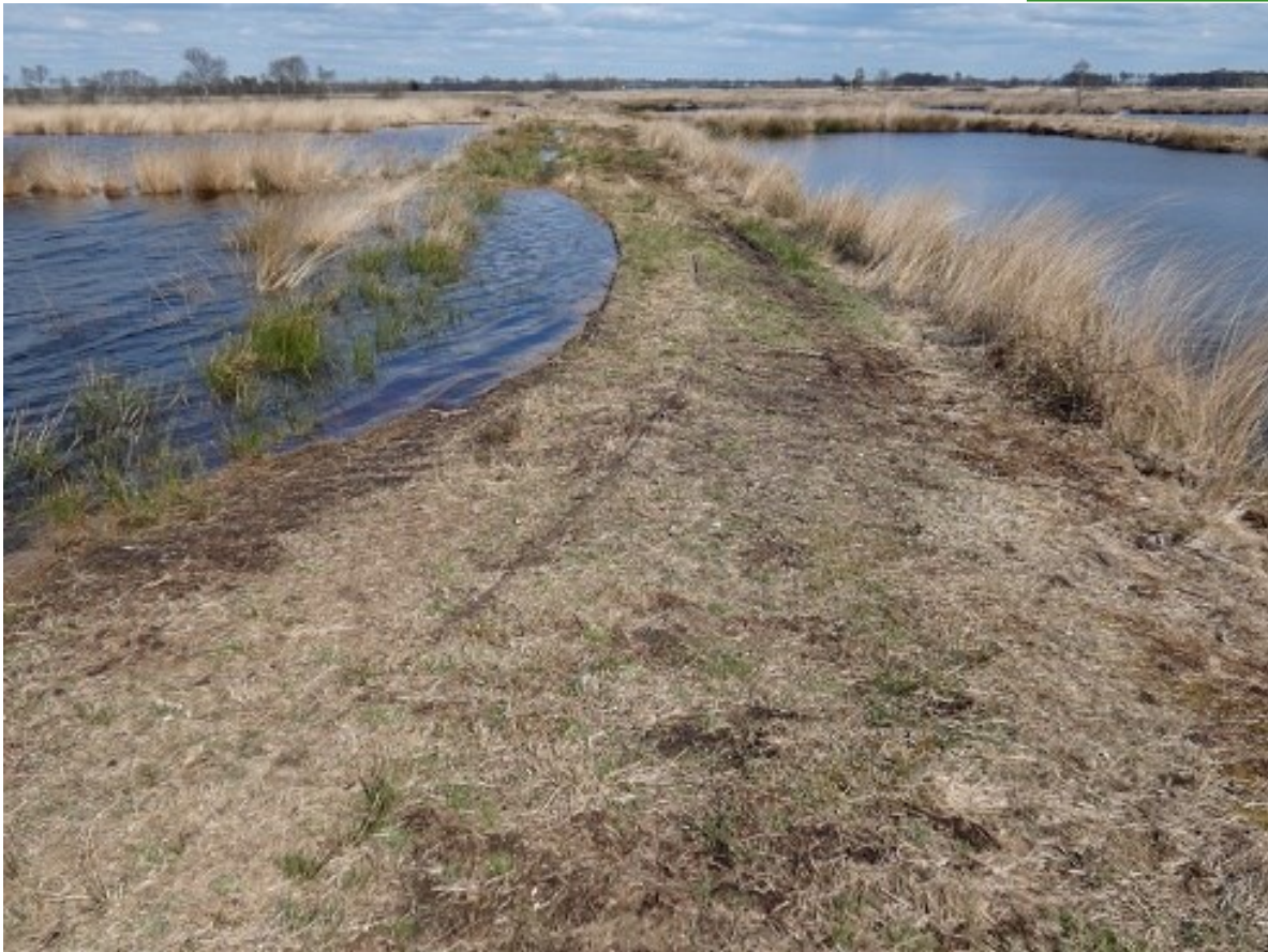
Figuur 2: veendam met spoorlijn die bijna doorgebroken is. De spoorlijn liep oorspronkelijk rechtdoor, maar is al ruim een meter opzij geschoven.
