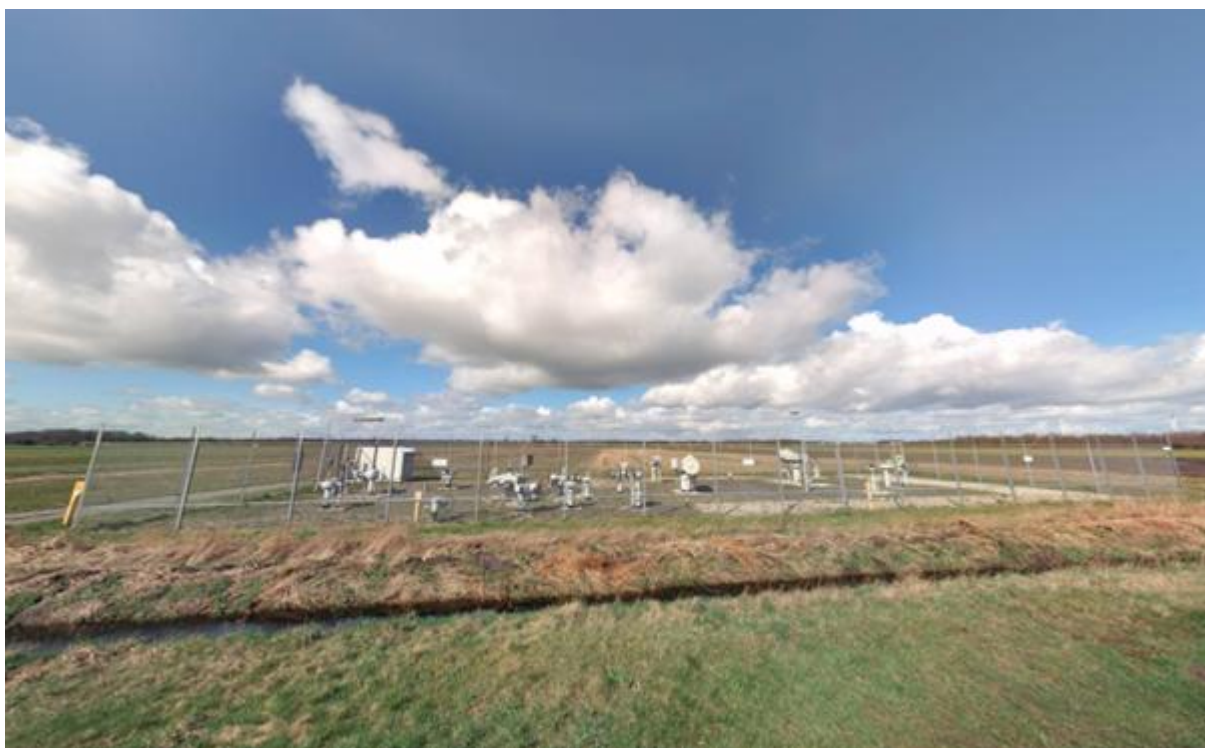
Figuur 3-1 Voorbeeld bestaande afsluiterlocatie aardgasleiding (S-216 Gasselternijveen)
